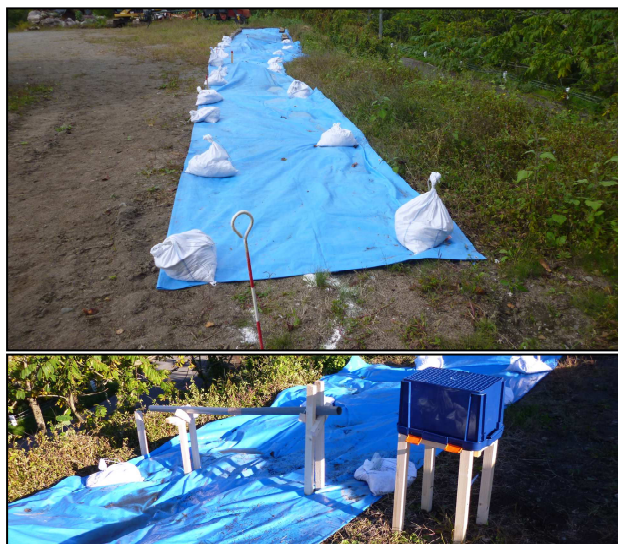
写真-2 応急対策
