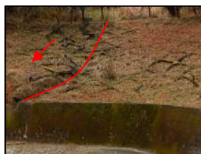
写真-2 法枠工変状状況
