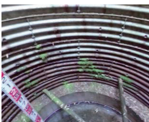
写真-6 ライナープレートの変状(せり出し)
