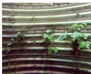
写真-7 集水管の閉塞(植生)
