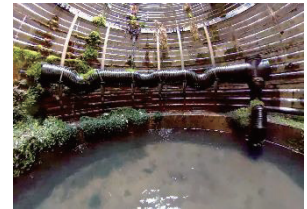
写真-9 集水孔口確認不可
