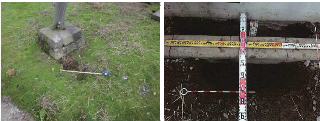
写真-1 陥没発生状況
