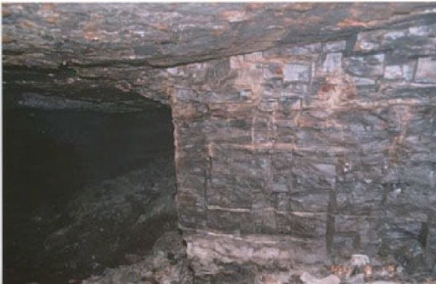
写真-1 地下空洞の例 1)
