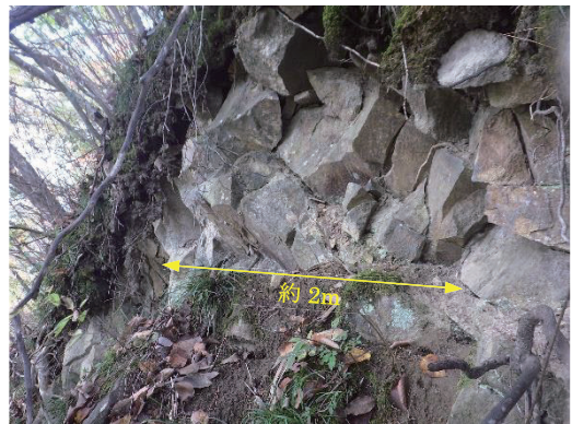
図-3 現地調査で確認した浮き石を伴う露岩
