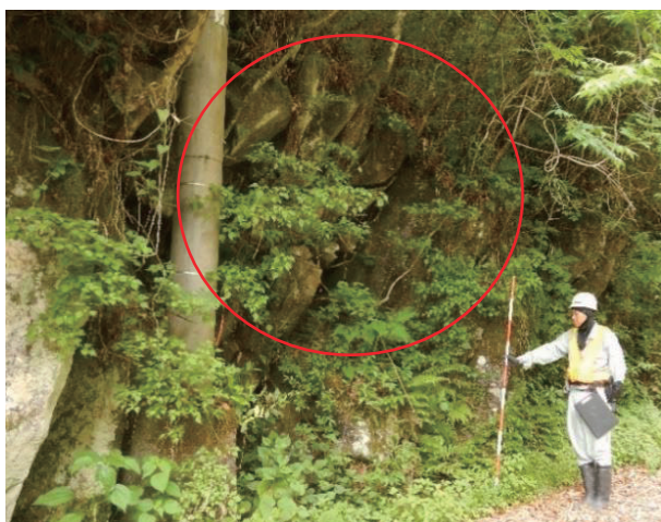
写真-3 切土による急崖露頭の浮石の不安定化
