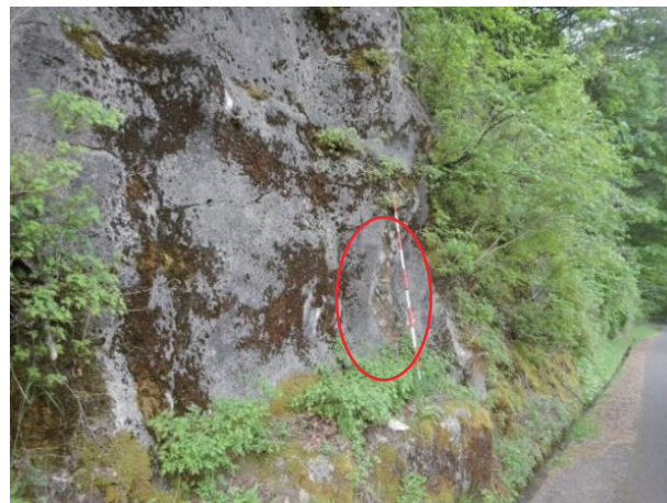
写真-2 モルタル吹付工の剥離進行・ラス金網の露出
