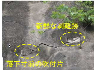
写真-2 配点が高くなる変状の例
