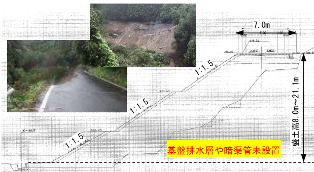
図-2 崩壊直後の状況と既往竣工図面
