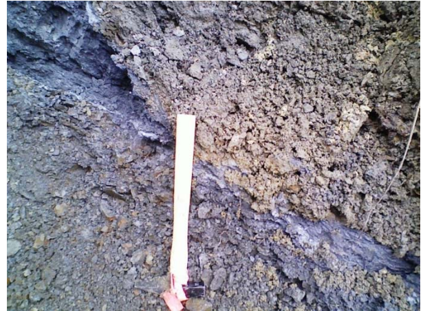
写真-1 末端部の粘土化した崩積土(泥岩)
