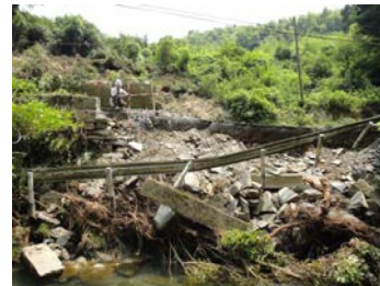
写真-2 路肩の崩壊状況
