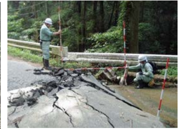
写真-3 道路面に生じた側方亀裂
