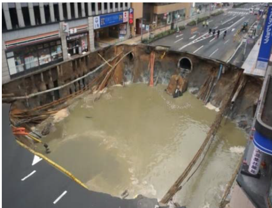
図1-3 地下鉄工事によって発生した駅前の陥没事故 2)
