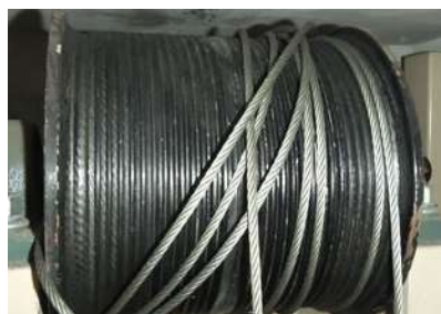
①乱巻きによるワイヤーの絡まり
