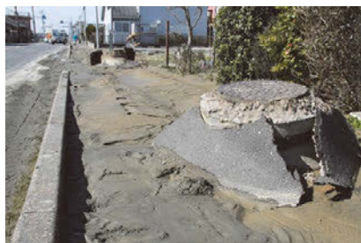
液状化によるマンホールの浮き上がり (香取市)
