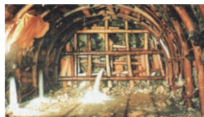
断層によるトンネル湧水
