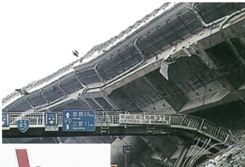
阪神・淡路大地震で壊れた 高速道路
