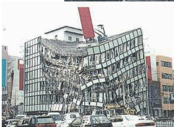
阪神・淡路大地震で壊れた ビル
