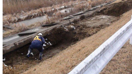
川表側護岸ブロックの前傾 (3/17)
