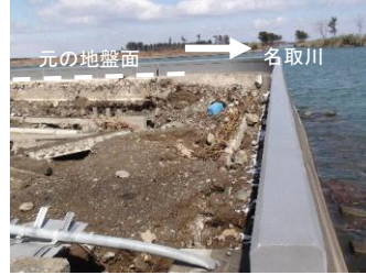
津波による堤内地盤の侵食 (閑上水門の直下流, 3/18)
