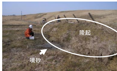
川裏側の基礎地盤の隆起と噴砂 (3/13)
