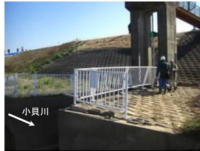
翼壁天端部の沈下 (3/18)
