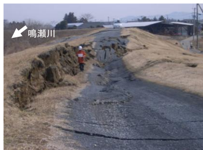
天端の沈下, 陥没 (3/13)
