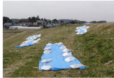
裏小段の亀裂 (4/15)
