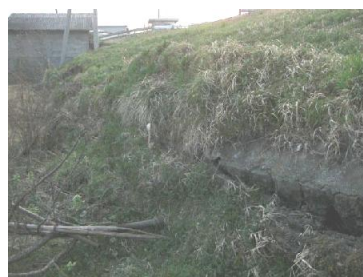
崩土に埋もれた石積み擁壁 (4/15)
