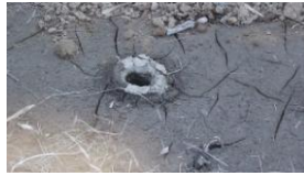
堤体の亀裂内の噴砂
