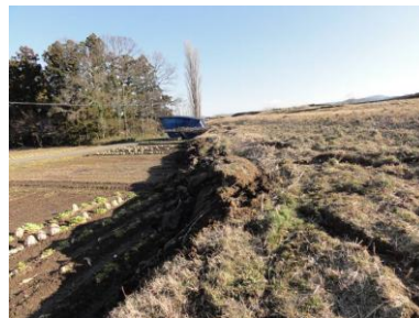
川裏側の耕作地を覆う崩土
