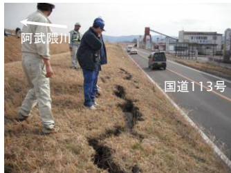
裏のりの縦断亀裂 4)
