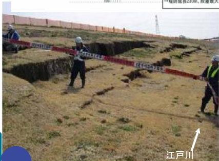
川表側のり面の陥没(地震発生直後)
