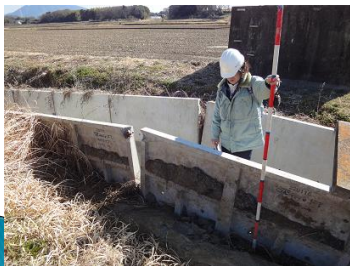
かんがい用水路の浮き上がり (3/18)
