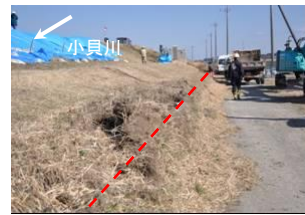
川裏側のり尻部のはらみだし (3/18)
