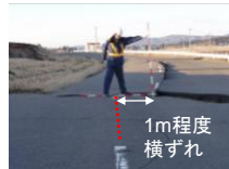
崩壊・未崩壊個所の境界でのセンターラインのずれ (3/18)
