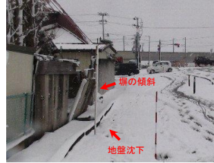
川裏側の民家付近の地盤変状 (3/17)
