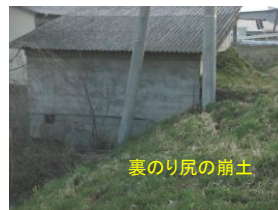
鳴瀬川右岸30k付近の裏のり尻 (4/15時点). 周辺住民によれば、地震直後には崩土が小屋に達していなかったとのこと。
