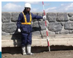
パラベットの背後の沈下 (3/18)
