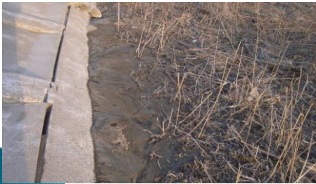
川表側のり尻部の噴砂痕 (3/13)
