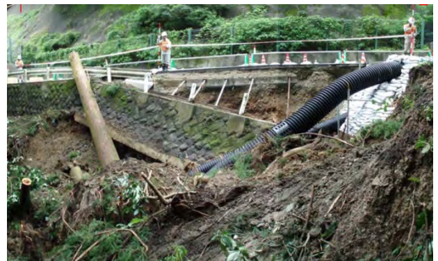
写真1 道路上の表流水の流入による路肩崩壊の事例（管轄事務所提供） 4)
