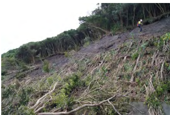
写真1 のり枠上方の表層崩壊（①地点） 枠内の樹木は倒伏したが、のり枠は被災していない
