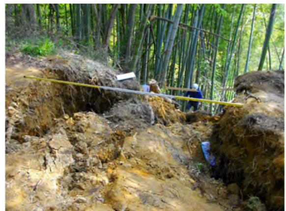
写真2 頭部の亀裂状況
