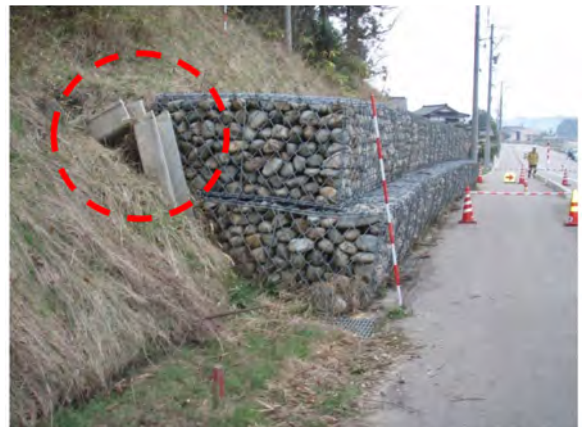
写真1 末端部水路の折れ曲がり
