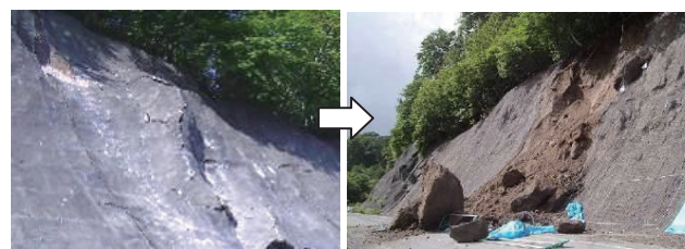
写真-2 吹付のり面凸部の崩壊事例 (管轄事務所提供)
