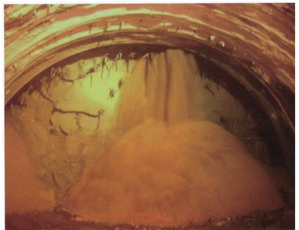
図-5 トンネル切羽崩落 13) (切羽から未固結の砂層が流出)
