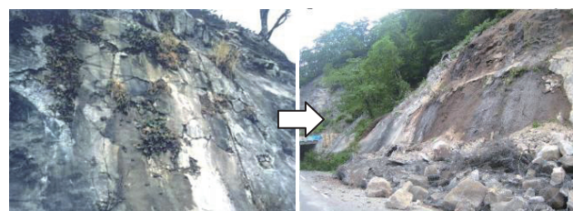
写真-1 亀裂が多数発達していたモルタル吹付工の崩壊事例 (管轄事務所提供)
