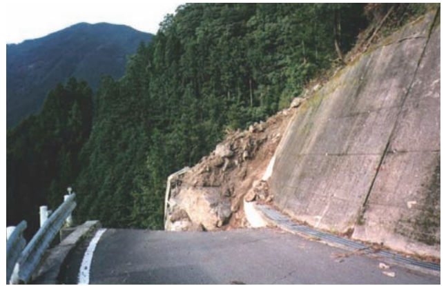
写真-8 道路災害の状況
