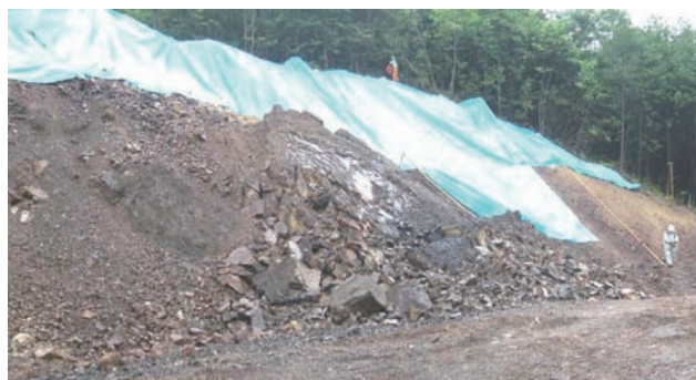
写真-7 切土法面の崩壊
